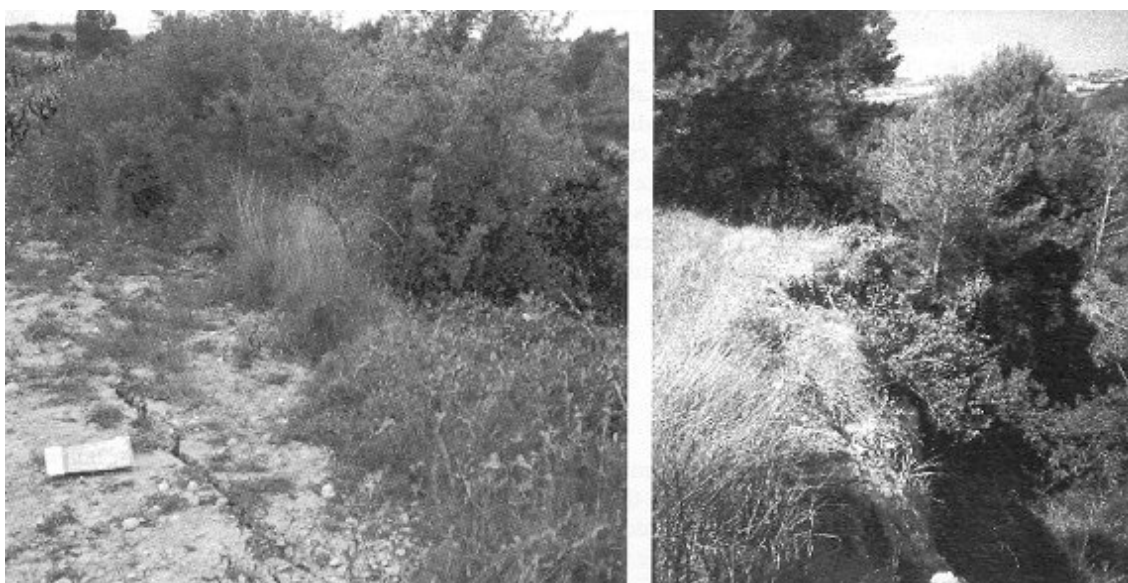
Figura 4. Fisuras producidas en el borde de las parcelas con los barrancos, con vegetación tipo matorral y arbolado en sus paredes, y deslizamiento que resulta en el retroceso de las paredes.
